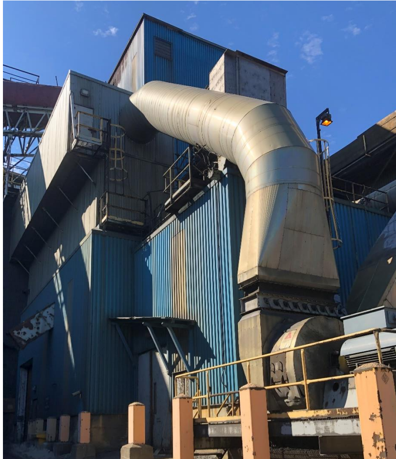
Exemple typique d'un dépoussiéreur, ici le DCOL 57
