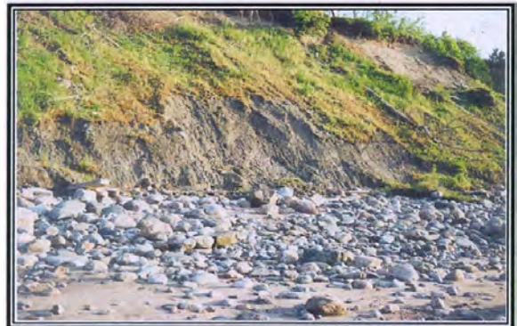
PHOTO 4 : Érosion en base du talus.
