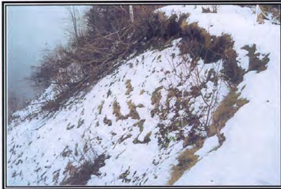
PHOTO 2 : Vue d'un effondrement d'un secteur en surplomb.
