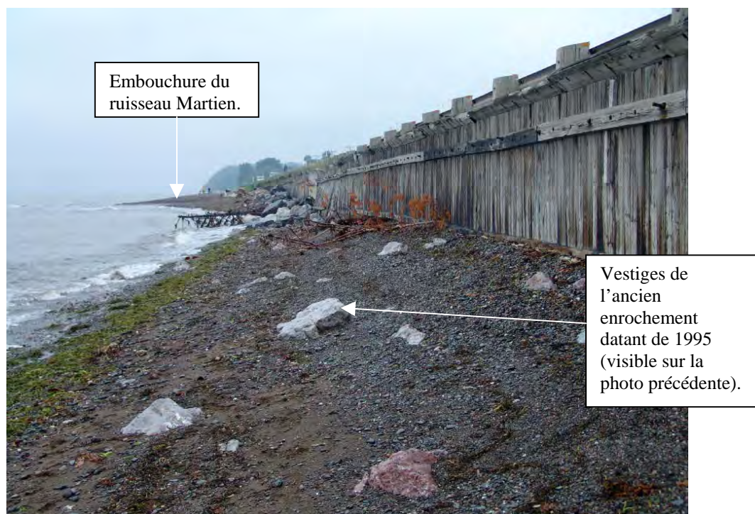
Photo 3 : Pied du mur affouillé à Maria (vue générale en direction ouest), secteur immédiatement à l'est du ruisseau Martien (19 juillet 2004)
