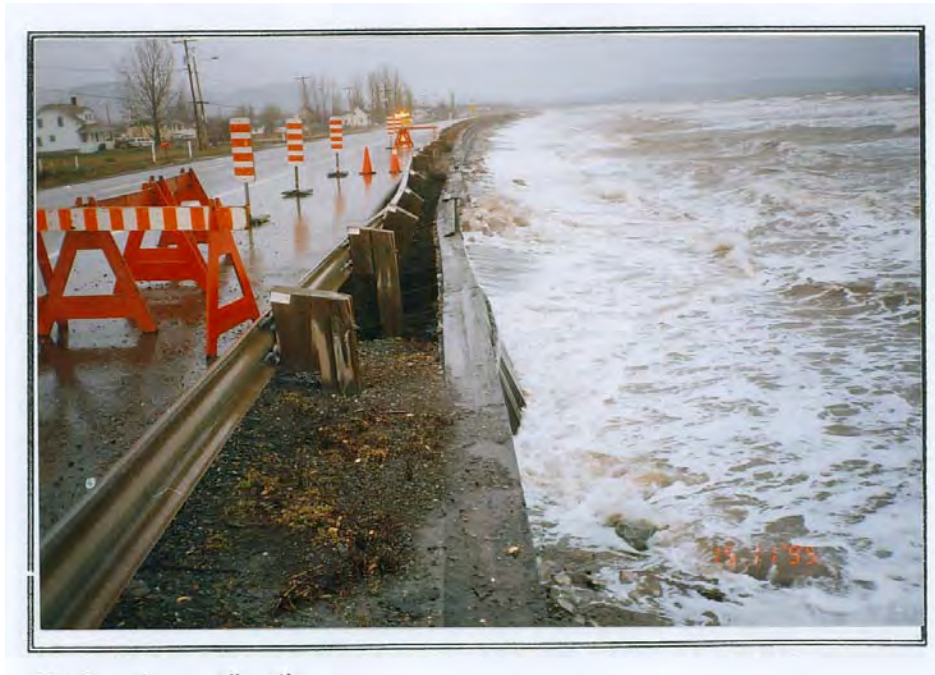
Photo 1 : Bris du mur de Maria lors d'une tempête en 1995 (direction est) ayant fait l'objet de travaux d'urgence, secteur immédiatement à l'est du ruisseau Martien (15 novembre 1995)
