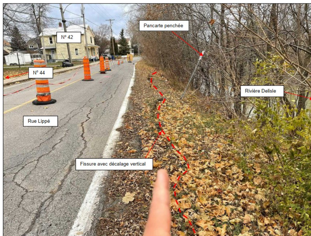
Figure 5 Vue générale de la paroi du talus dans le secteur du 44, rue Lippé (Solmatech, 2025)
