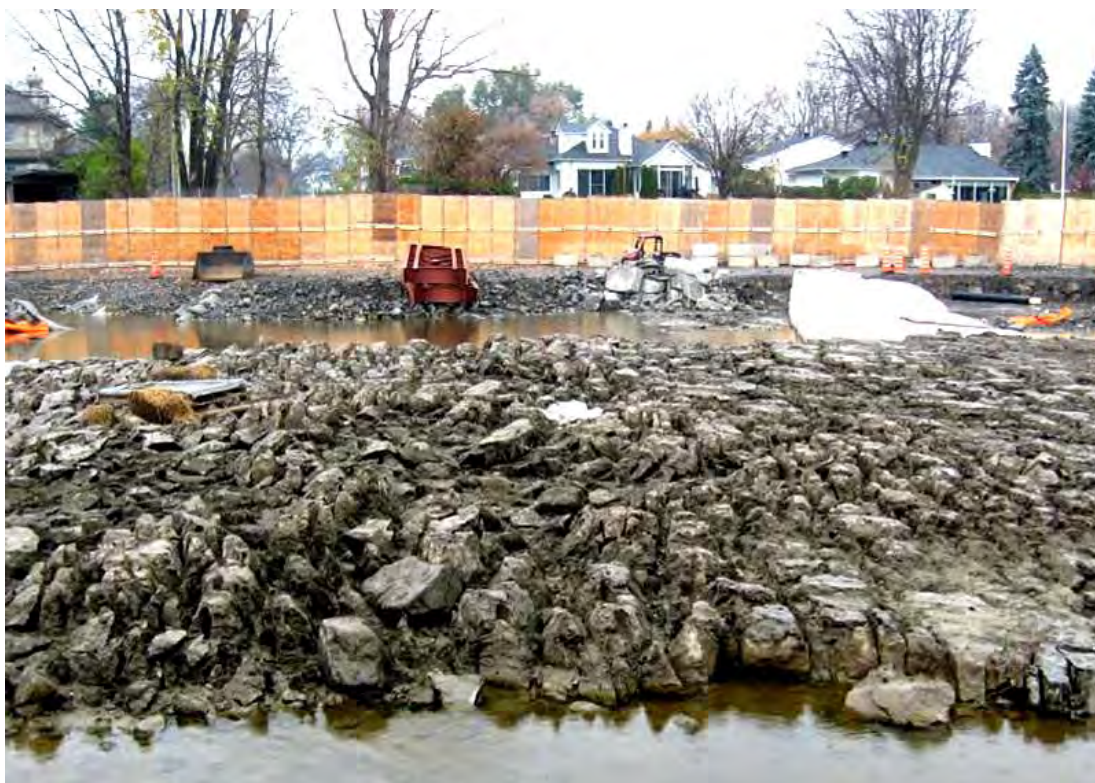
FIGURE 3 : ROC INDIGÈNE FRACTURÉ OBSERVÉ UNE FOIS L'ENCEINTE DU BATARDEAU ASSÉCHÉE (PREMIER PLAN)
