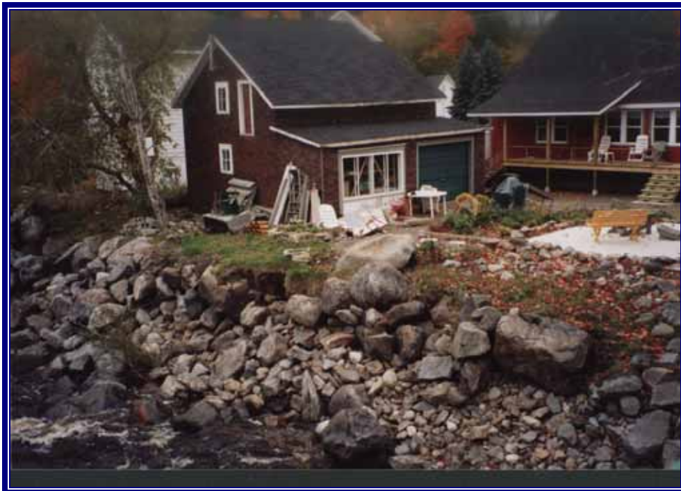
FIGURE 3 : ÉTAT DE LA BERGE EN RIVE DROITE EN AVAL DU PONT DE LA PRUCHIÈRE
