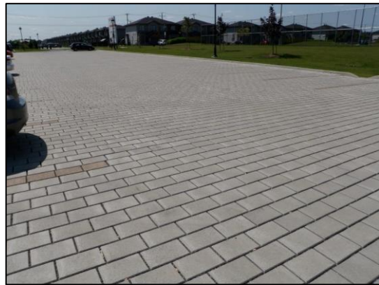
Source : INRS/Catherine Vaillancourt Pavés perméables autobloquants au stationnement du parc des Patriotes, à Chambly
