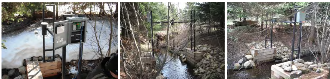
Photos 8, 9 et 10. Station ultra-sons d'enregistrement en continu des débits entrants (Photos n os 8, 9 et 10, Groupe AIM inc.)
