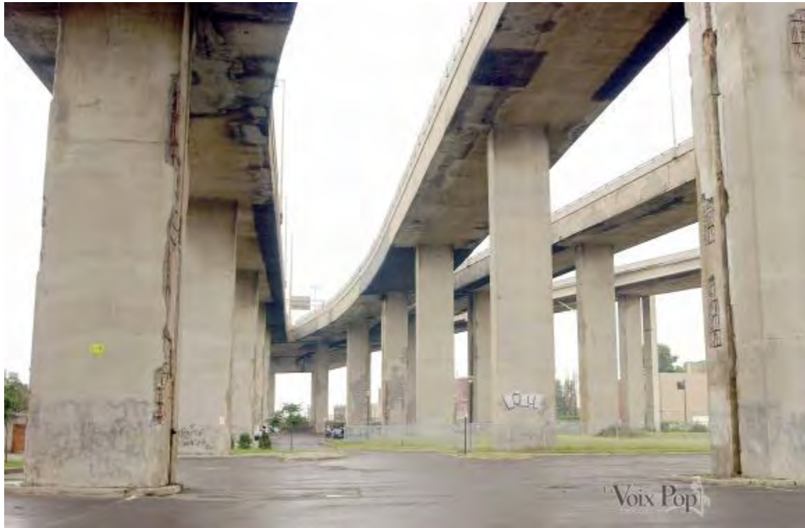
FIGURE 2 - EXEMPLE DE L'ÉTAT D'UNE INFRASTRUCTURE DU COMPLEXE TURCOT
