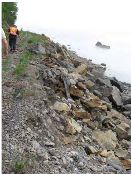
1. Érosion au point milliaire 30,8
