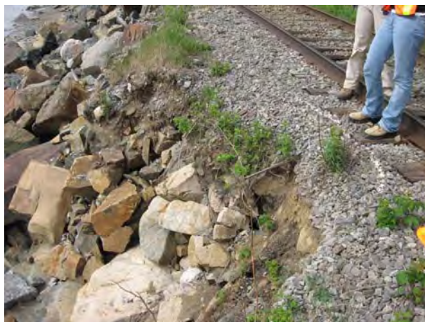
2. Érosion au point milliaire 32
