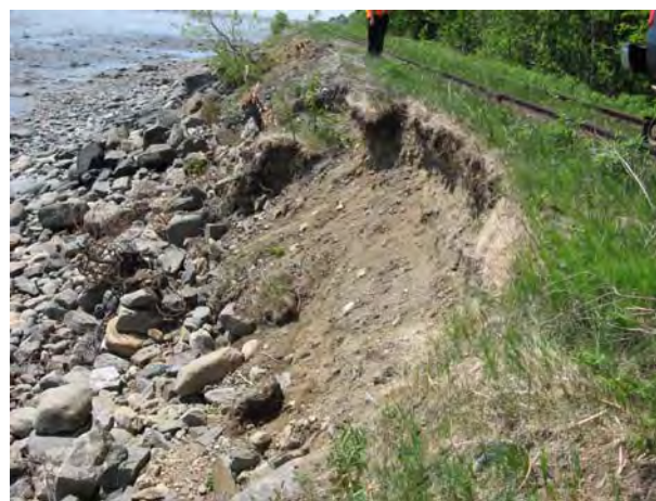
4. Érosion au point milliaire 47,5
