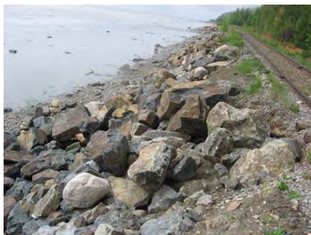
3. Érosion au point milliaire 32,2
